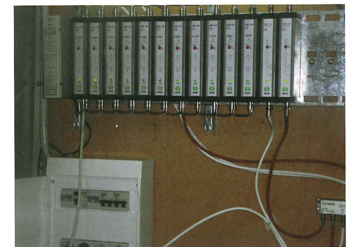
Figura 1.11. Instalación de distribución de la señal de TV (tipo A).
