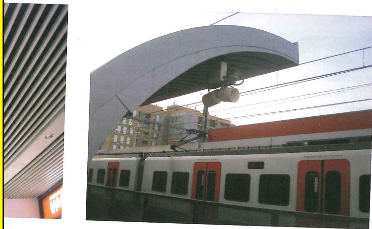
b) Sistema de avisos y alarma por voz.
